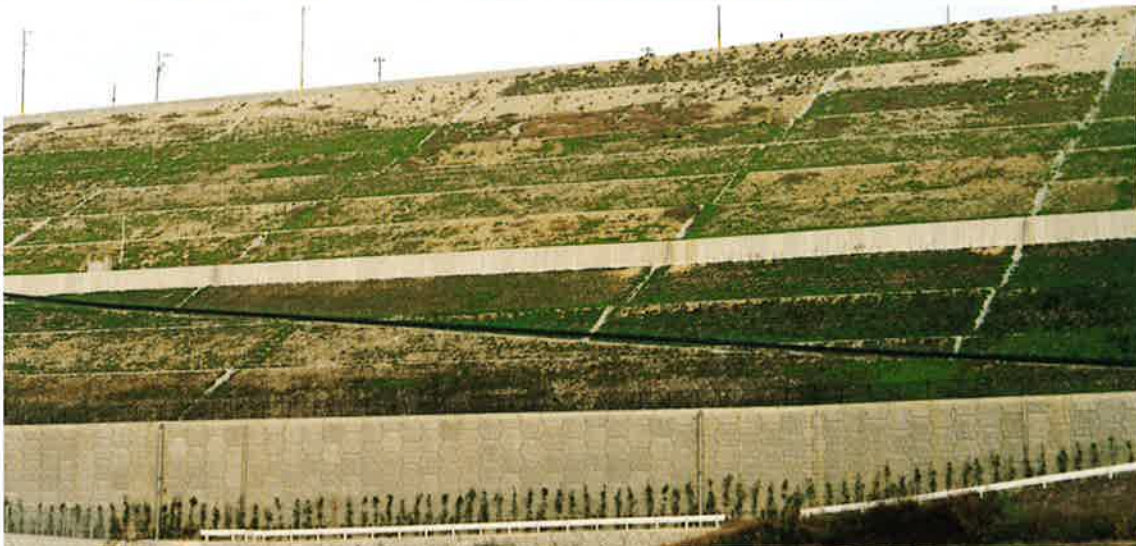
広島県 / グリューネン入野造成 上載盛土 12段 法勾配 1:1.8 全高 60m 総壁面積 10,109m 2 壁高 15.75m
