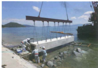
写真-2 香川県高松市女木町 ボックスカルバート 1000×600mm
