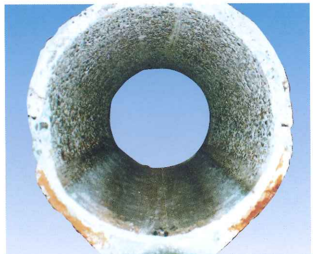
●下水道内でのコンクリートの腐食の様子
